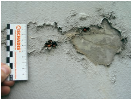
Bild 5: Marienkäfer nutzen das feucht-warme Klima in den Defekten der Beschichtung, die durch Ablösung der Beschichtung über dem Rissverlauf entstanden sind
