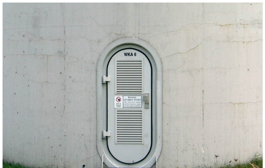
Bild 9: Risse um die Tür
