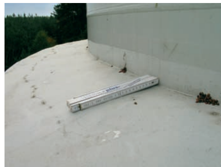
Bild 7: Beginnende Ablösung, erkennbar an Defekten in der Beschichtung
