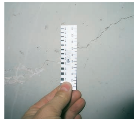
Bild 6: Risse im Innenraum, teilweise versintert
