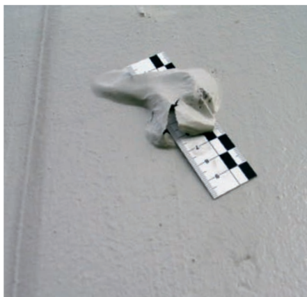
Bild 4: Blasen unter der instand gesetzten Beschichtung
