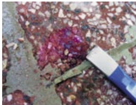
Bild 4: Probenahme für den Phenolphthalein-Test bzw. für die Suche nach Keimen an einem Oberflächendefekt im Fugenkreuz
