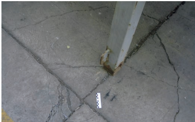
Weitere Schadensbilder zeigten Eckenabbrüche und Fugenversätze.
