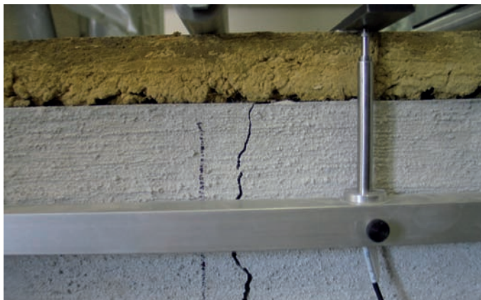
Prüfung des Estrichs in einem verformungsgesteuerten Biegezugversuch. Es ist deutlich erkennbar, dass der Beton als tragender Untergrund bereits gerissen ist.
